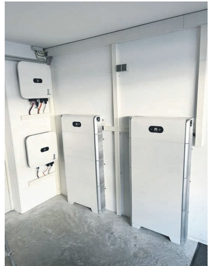
Ein Blick ins „Herz“ der Solaranlage: Die Wechselrichter (links an der Wand) und die Speicher (rechts) verwalten den von den Modulen auf dem Dach produzierten Strom. Dabei nehmen sie nur minimalen Platz in Anspruch. Foto: Biber Solarkonzept
