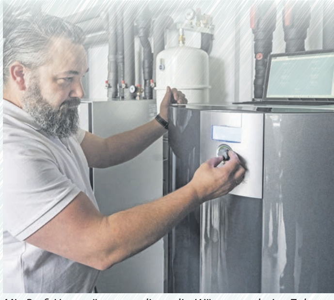
Mit Profi-Unterstützung gelingt die Wärmewende im Zuhause: Fachhandwerker begleiten die Modernisierung von der ersten Planung bis zur Inbetriebnahme der Wärmepumpe. Foto: djd
