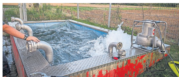
Die Schmutzwasserpumpen (rechts auf dem Beckenrand) wurden geprüft und für kommende Einsätze bereitgestellt.
