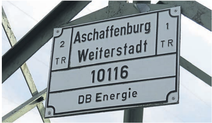
Schilder weisen auf Masten hin, die Strom für die Bahnstrecke liefern. Foto: Adl252
