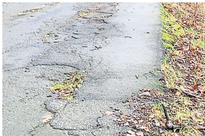
Aufgrund der schweren Schäden ist eine Öffnung der Straße bis zum Beginn der Sanierungsarbeiten nicht möglich.
